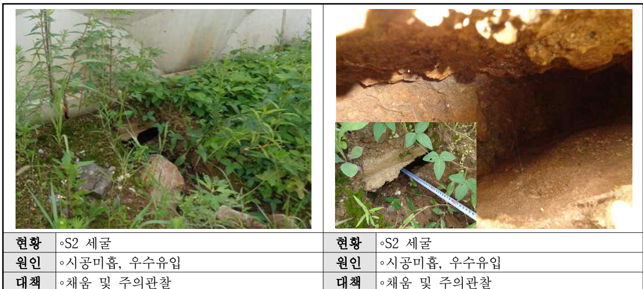
【사진 5.4】 옹벽 전면부 주요 손상 및 현황
